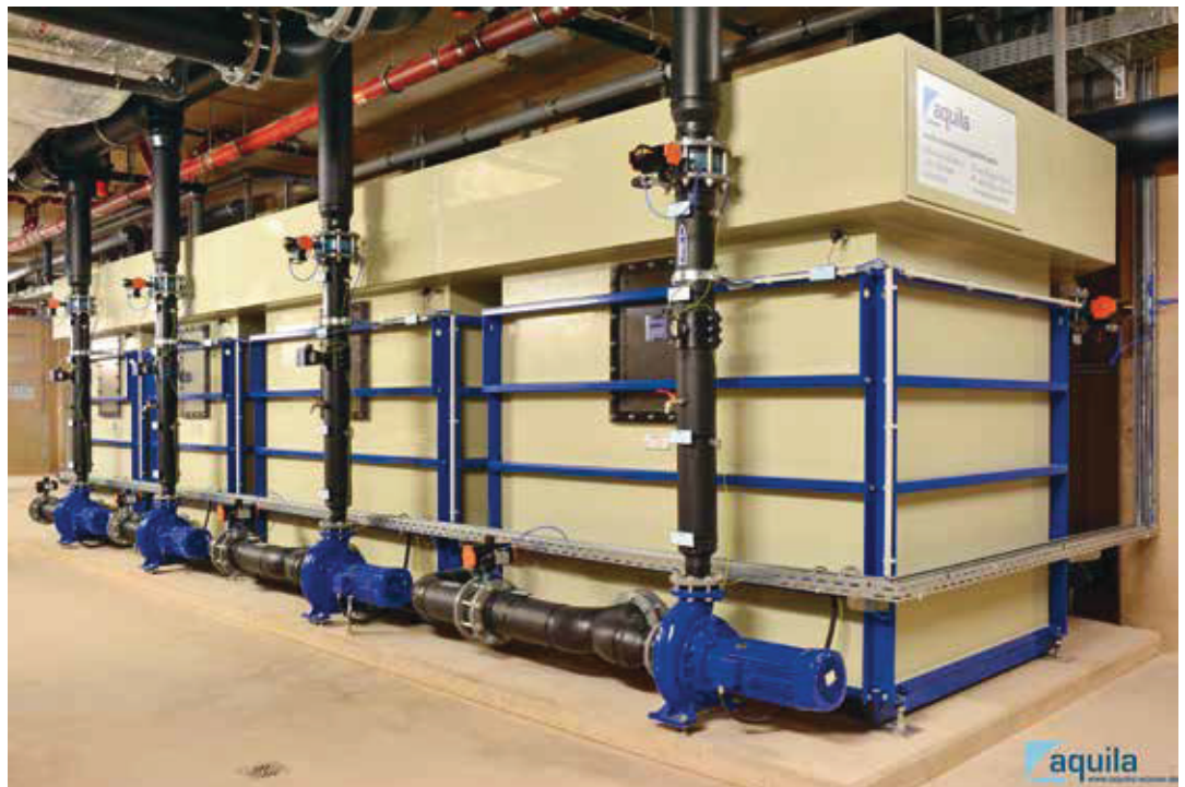
Ein fertiger Technikeller der aquila wasserauf- bereitungstechnik GmbH.
