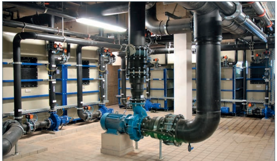
■ Die vor sieben Jahren installierte Badewasseraufbereitungsanlage
